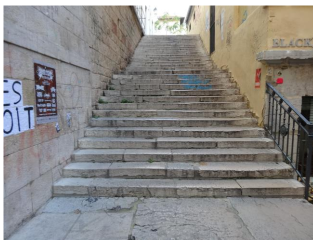
PHOTO N° 2 – 2 ème volée côté droit
